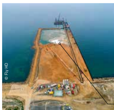
La plateforme arrière du quai se remplit progressivement.
