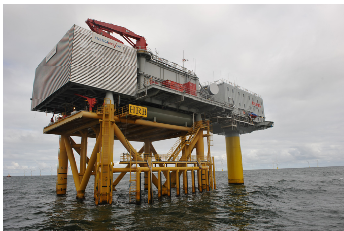
Figure 16. Sous-station sur le parc d'Horns Rev 2.
