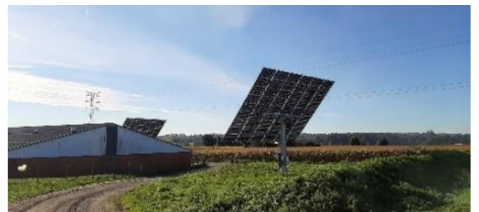
Trackers solaires dans des exploitations agricoles Crédit photo : Région Bretagne / SCOFE
