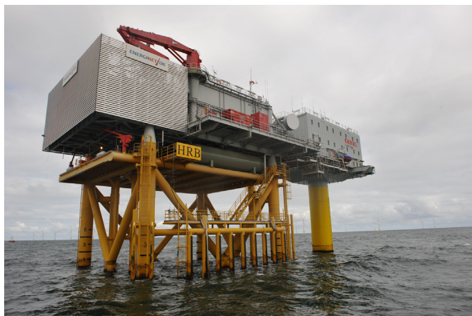
Figure 16. Sous-station sur le parc d'Horns Rev 2.
