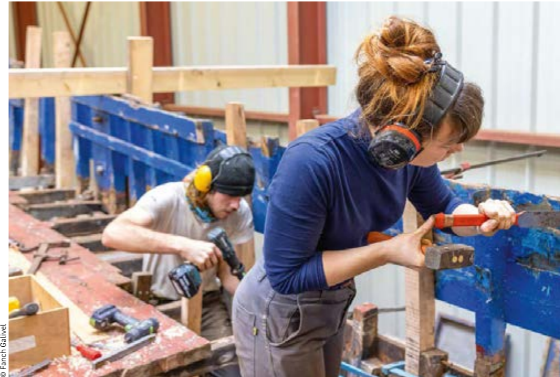
Les charpentiers de l'Atelier Ribines s'attaquent aux jambettes du Bass Loc'h, le bateau du club de plongée d'Audierne.
