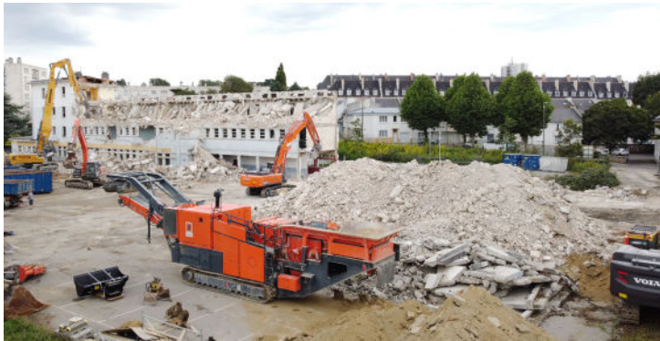
L'équivalent de 7 560 tonnes de béton ont été broyés sur site et réutilisés pour le terrassement
