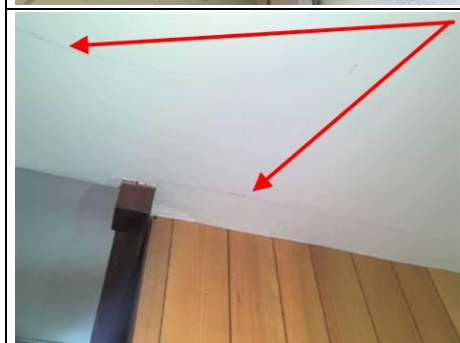
Photo n° PhTer006 Localisation : RdC/1er - Escalier; 2e étage - Palier; 2e étage - Bureau 9 Ouvrage : Plafond Informations complémentaires : Fissures
