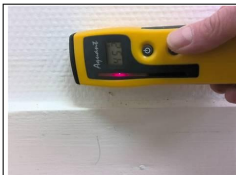
Photo n° PhTer003 Localisation : RdC - Salle de réunion; RdC - Bureau 5 Ouvrage : Murs périphériques Parasite : Humidité Indices : Présence d'humidité (Relevé hygrométrique supérieur à 50%)
