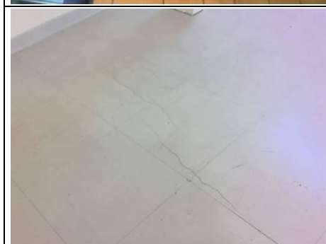
Photo n° PhTer007 Localisation : 1er étage - Cafétéria Ouvrage : Sol Informations complémentaires : Fissures
