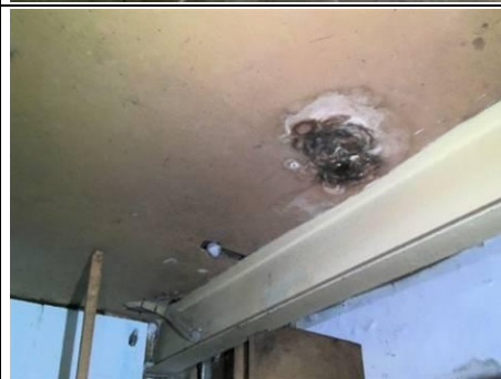
Photo n° PhTer002 Localisation : SS - Chaufferie Ouvrage : Plafond Parasite : Humidité, Moisissures Indices : Présence d'humidité, Présence de moisissures
