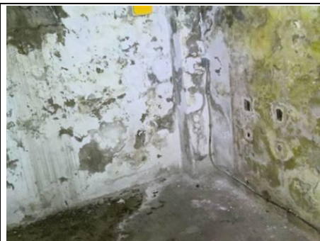
Photo n° PhTer001 Localisation : SS - Chaufferie Ouvrage : Mur, sol Parasite : Humidité, Salpêtre Indices : Présence d'humidité, Présence de salpêtre
