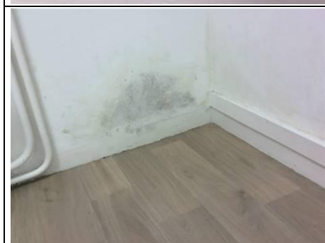
Photo n° PhTer004 Localisation : RdC - Bureau 2 Ouvrage : Pied de mur Parasite : Humidité, Moisissures Indices : Présence d'humidité, Présence de moisissures
