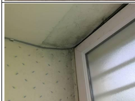
Photo n° PhTer005 Localisation : RdC - Wc; 1er étage - Sanitaires Ouvrage : Périphérie de la fenêtre Parasite : Humidité, Moisissures Indices : Présence d'humidité, Présence de moisissures
