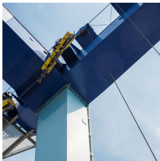
Détail, en contre plongée, de l'élévateur à bateaux de l'aire de réparation navale.
