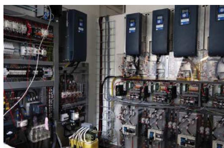
Module de stockage stationnaire de batteries © Energie Plus
